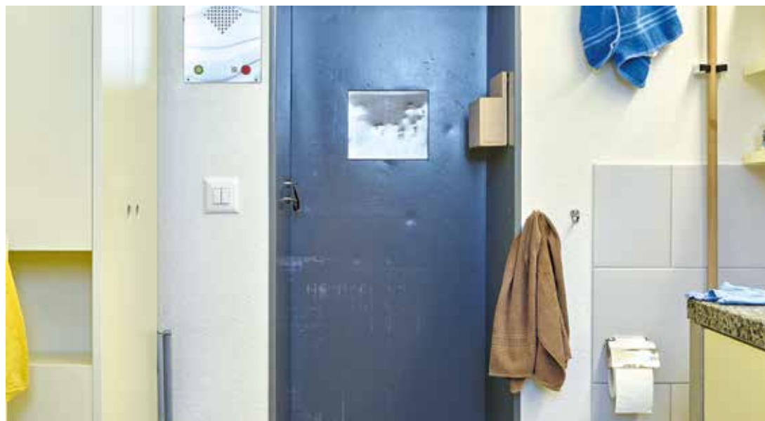
Les interphones installés dans les cellules seront remplacés d'ici 2023 par un système complet de communication numérique. Photo : Peter Schulthess, 2019
